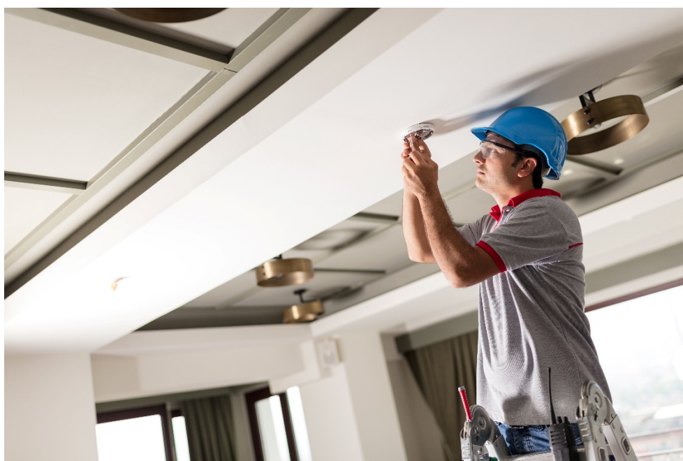
Foto 2: Im gesamten Gebäudekomplex werden u.a. automatische Brandmelder installiert. (© iStock/nilimage)
